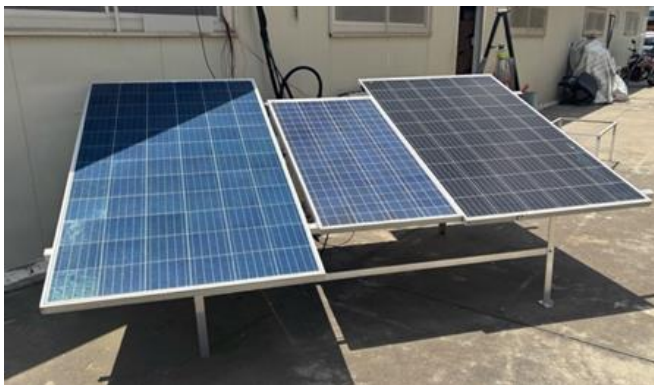
Figura 1. Sistema montado en sitio con afectación de sombras.
